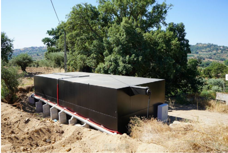
Imagem 85 – ETAR - Estação de tratamento de águas residuais
